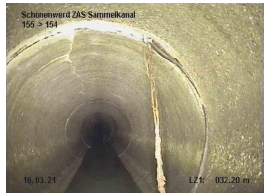
Abbildung 5 KS155 - KS154 Risse, Wurzeleinwuchs, Dichtring einragend
